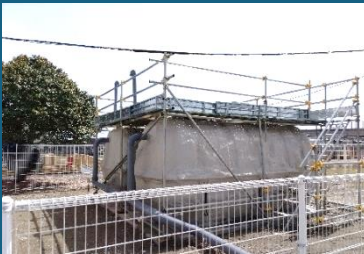
仮設住宅用浄化槽(地上設置)
