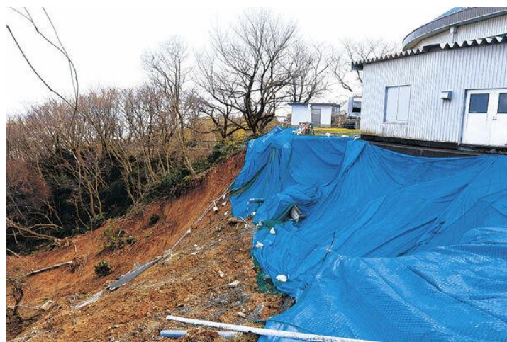
崩落した斜面（富山新聞より）
