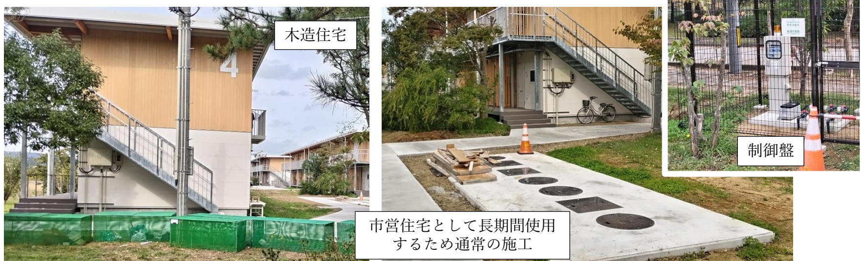
「まちづくり型」 応急仮設住宅用 浄化槽設置状況（FXU 型）
