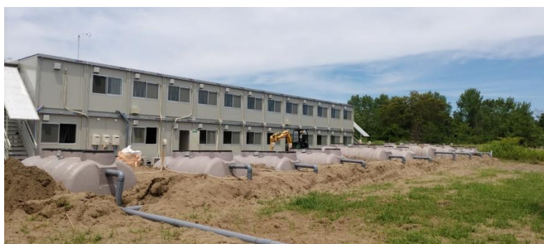
珠洲市仮設宿舍用(民間)仮設浄化槽 30 人槽×6、40 人槽×4 七尾営業所提供
