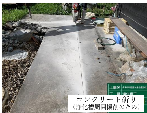
被災浄化槽(既設)
