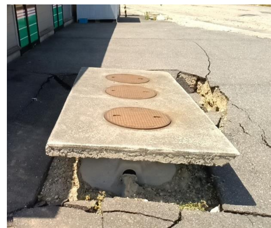
被災した浄化槽
